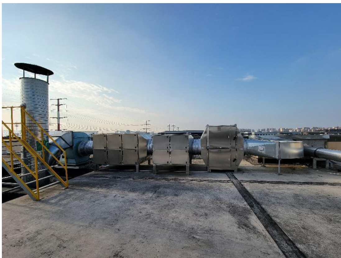
图 4-2 废气处理设施
