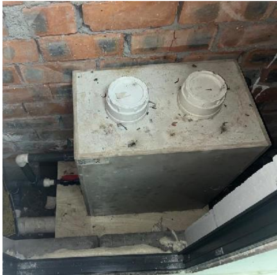
图 4-2 污水处理设备
