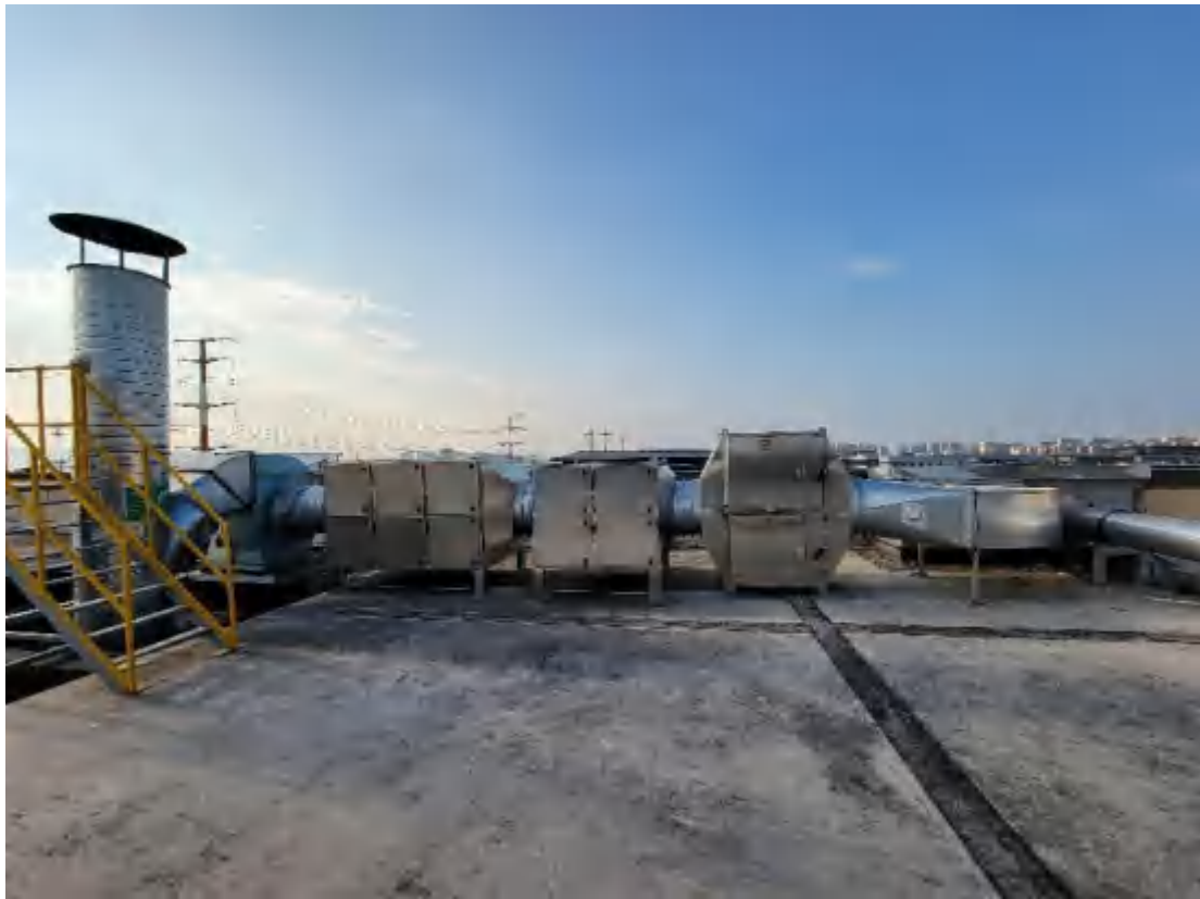
图 4-2 废气处理设施（过滤棉+UV 光氧+两级活性炭吸附）
