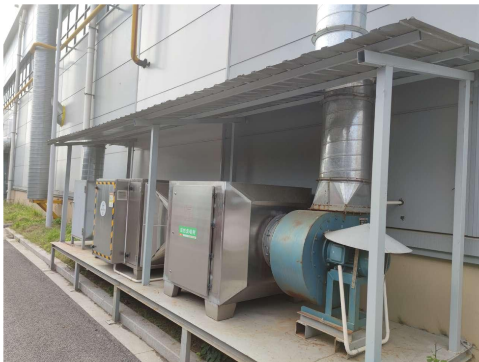
图4-9 喷塑固化废气、天然气燃烧废气处理设施图
