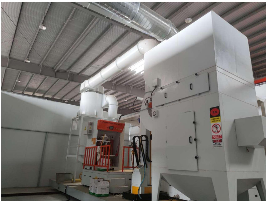
图 4-7 喷塑废气西处理设施图
