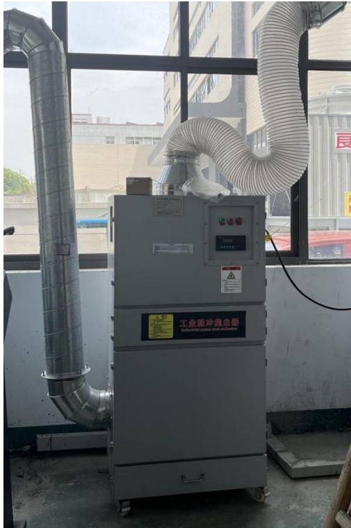
图 4-1 废气处理设施
