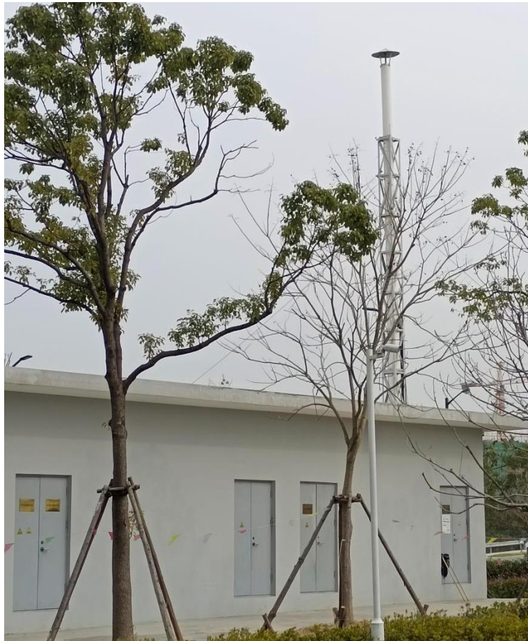
图 4-2 废气处理设施
